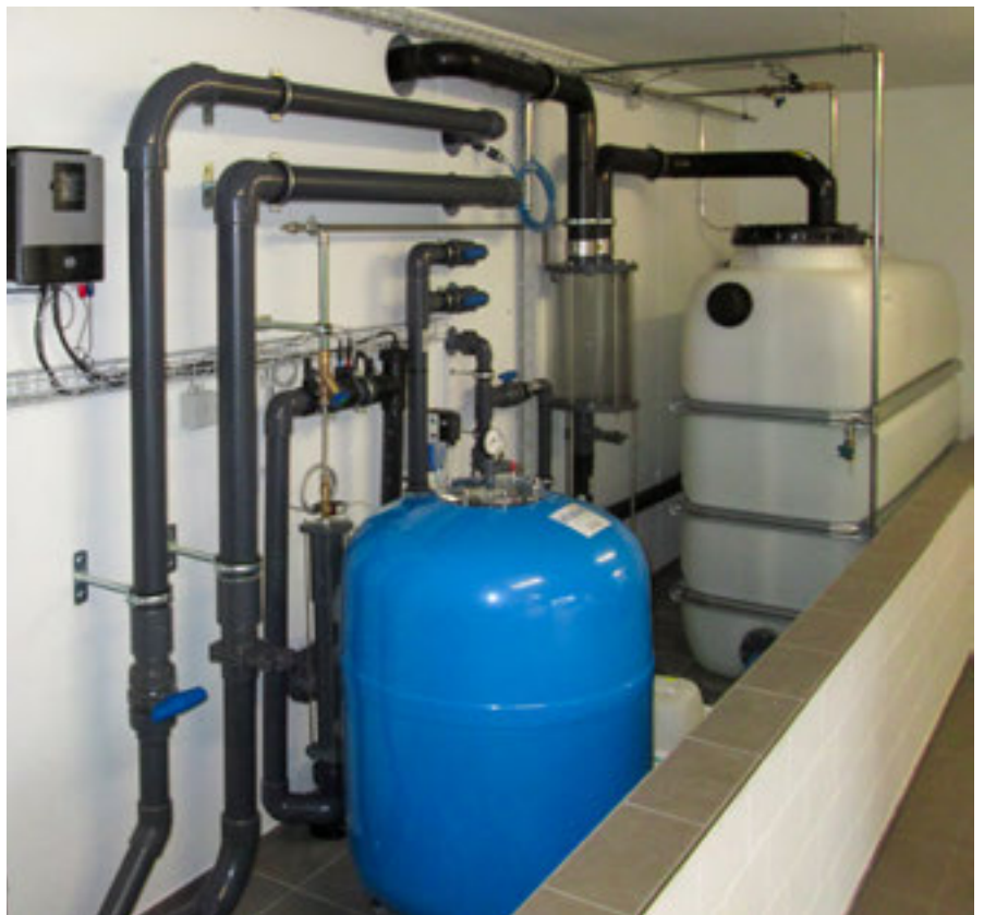
Der Sandfilter (blauer Behälter) hält gröbere Verunreinigungen zuverlässig zurück.
